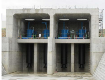
小川内水排除設備 ・発電機 750kVA 2機 ・京都府木津川市/2024年3月
