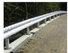
ガードレール
